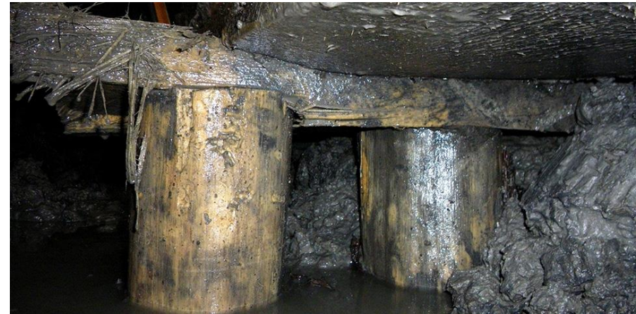
Voorbeeld schade houten paalfundering door droogstand (gww-bouw.nl)
